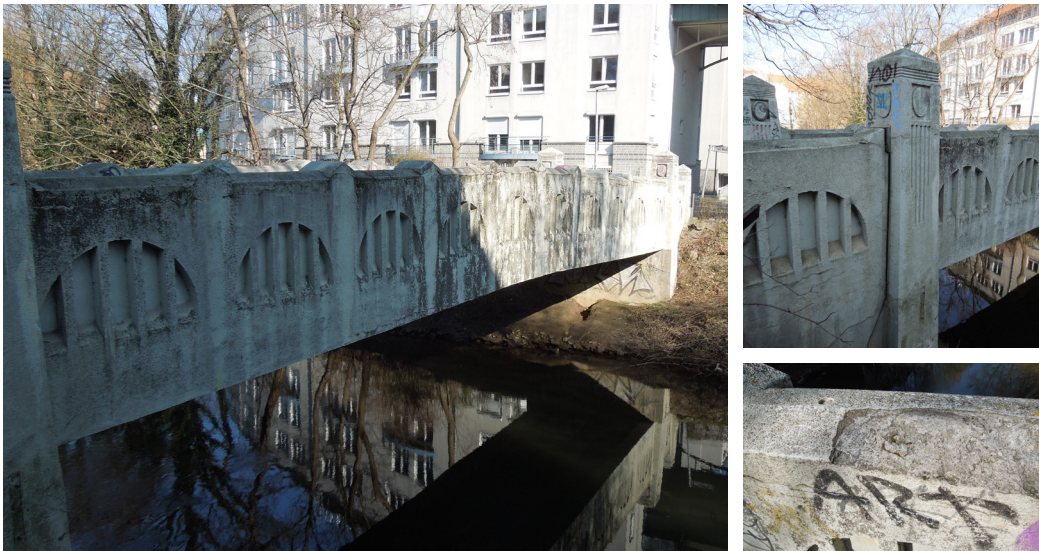
Bild 2. Schäden an den Hauptträgern vor der Sanierung
